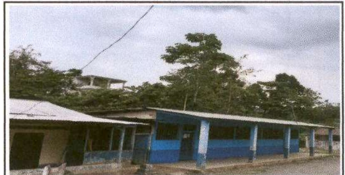
Foto 6: Pintura general en mal estado
