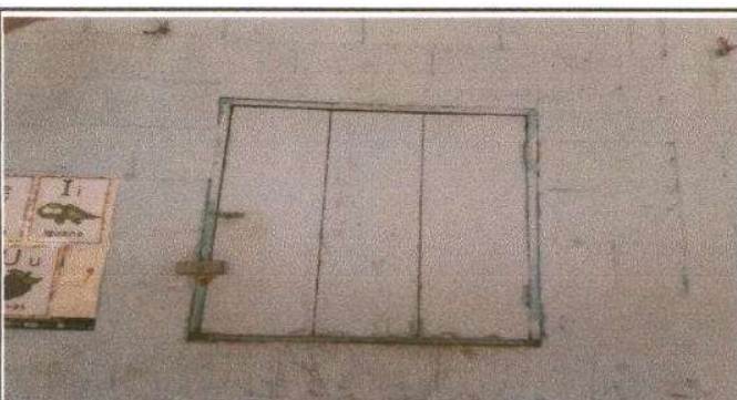
Foto 5: Ventanas de madera en mal estado
