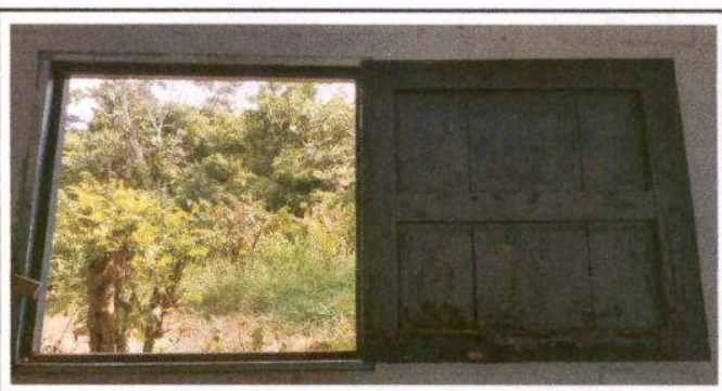
Foto 6: Ventanas en mal estado
