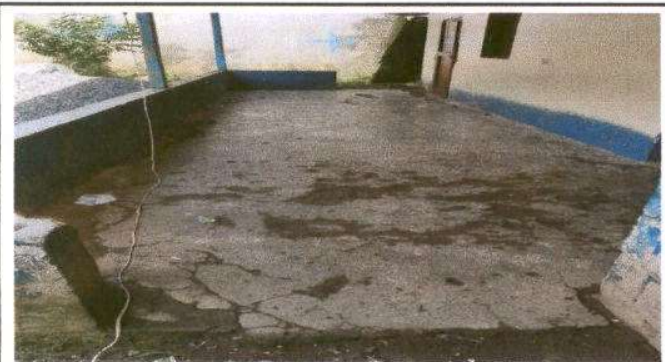
Foto 3: Piso del corredor de la escuela en mal estado.
