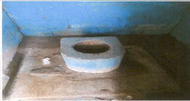
Foto 1: Inodoro de cemento y piso de cemento en mal estado.
