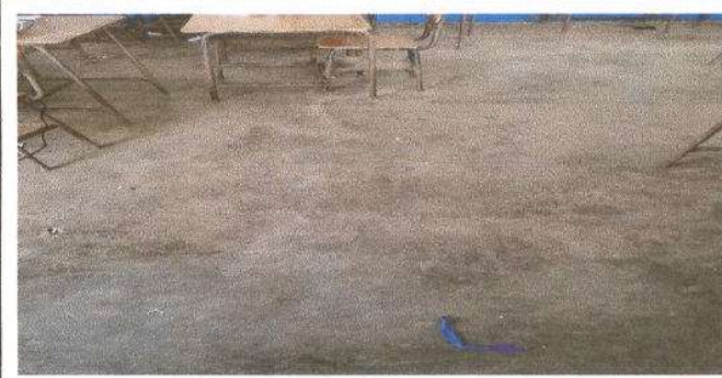
Foto 3: piso de aulas en mal estado
