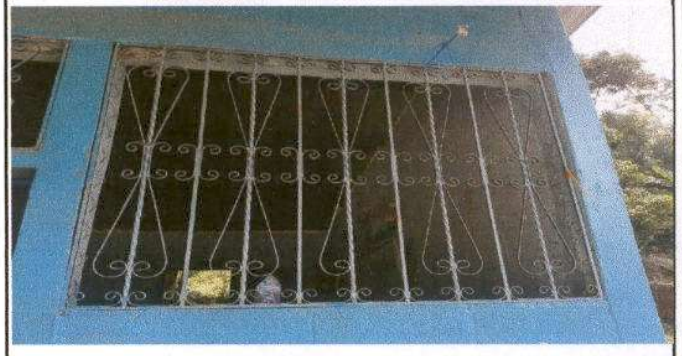
Foto 2: Barandas despintadas y en mal estado
