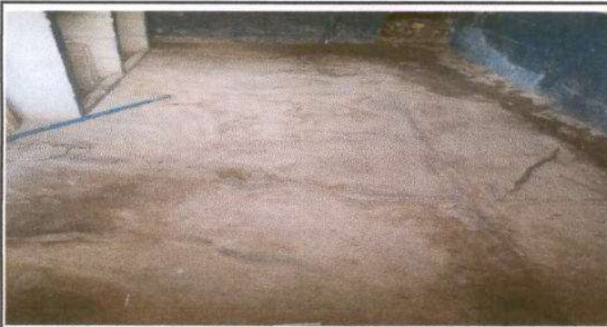
Foto 3: Piso de la cocina en mal estado y con grietas.
