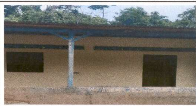
Foto 4: Puerta y ventana de aula en mal estado.
